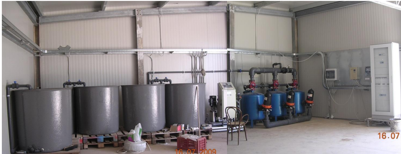
Sala di Fertirrigazione «in linea»
